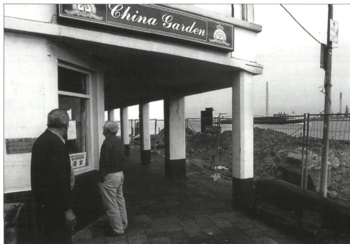
Restaurant China Garden moet op last van de gemeente sluiten, nadat door werkzaamheden aan het Westerhoofd de muren zijn gaan scheuren (19 oktober) (CRD)
