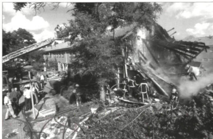
Een gasexplosie vaagt een hoekwoning aan de Van Bleiswijkstraat volledig weg (19 september). (Foto Roel Dijkstra).
